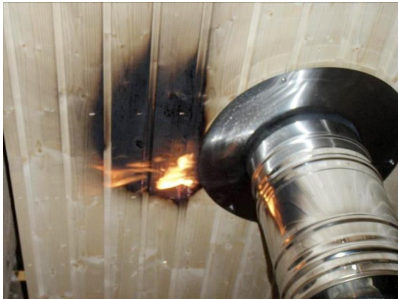
Kuva 5 Paneelit syttyivät noin 6 tunnin kuluttua lämmityksen aloituksesta.
