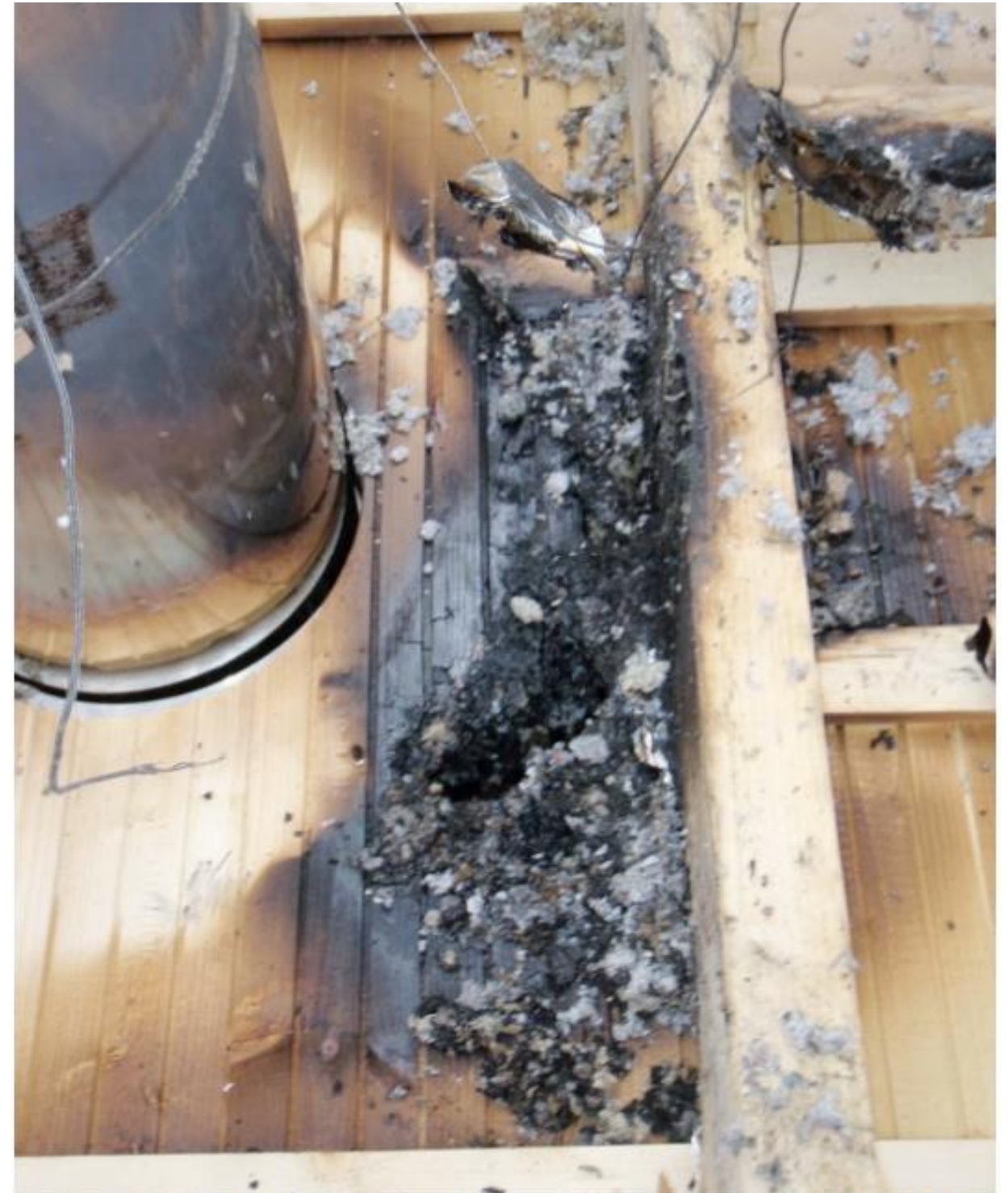
Kuva 6 Vauriot paneeleissa kokeen jälkeen. Palo on levinnyt paneeleihin ylhäältä selluvillasta paloeristeen läpi.
